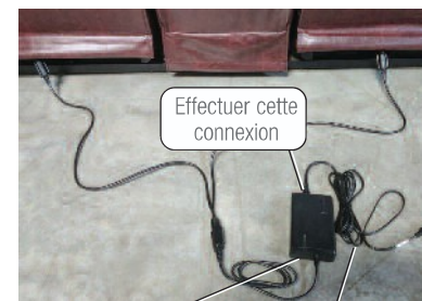
Transformateur électrique Cordon d'alimentation de 120 volts
