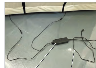
Transformateur électrique Cordon électrique de 120 volts
