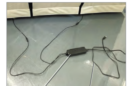
Transformateur électrique Cordon électrique de 120 volts
